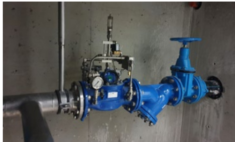
Übergabeschacht Wasserversorgungsanlage Inzing
